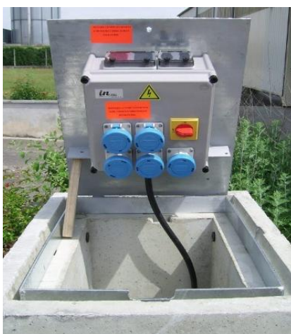
Figure 14 : Coffret de chantier pouvant favoriser l'eau stagnante (2024) (source : Agence régionale de démoustication – ARD)
