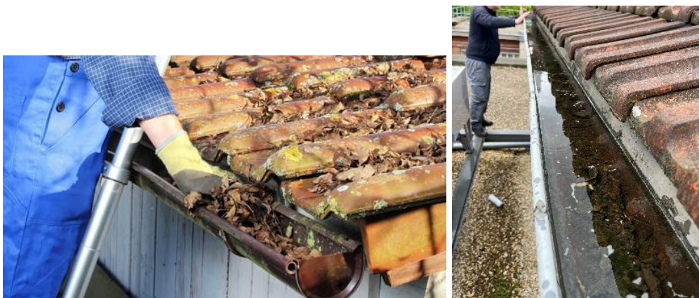
Figure 12 : Gouttières avec débris végétaux et présence d'eau stagnante (2024) (source : Agence régionale de démoustication – ARD)
