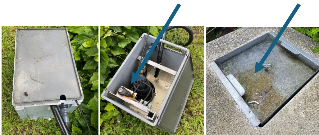
Figure 15 : Chambre et boîtier électrique avec de l'eau stagnante (2024) (source : Agence régionale de démoustication – ARD)
