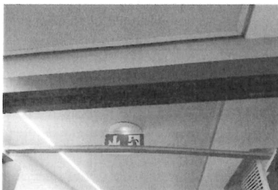
3 e étage - porte coupe-feu maintenue ouverte avec une planche en bois
